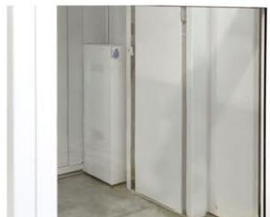
Solución MRL, control y central dentro del hueco.
